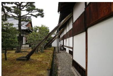
修理前（本丸御殿玄関） つかえ棒で支える
