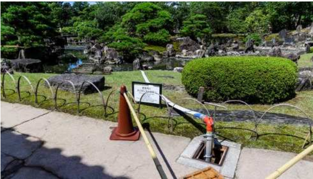
⑤消火栓にホースをセット
