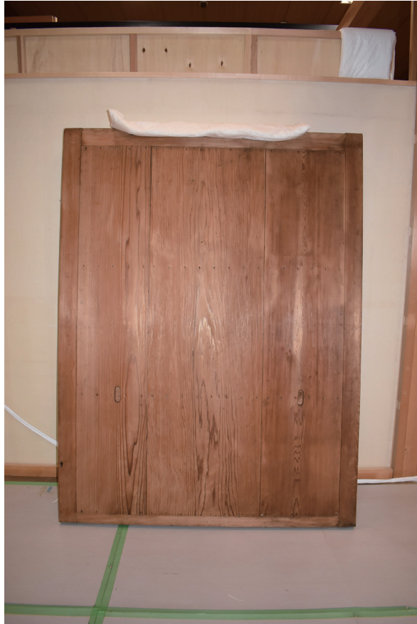
口絵 1 遠侍帳台の間 帳台構襖（東より1）障壁面を捲った状態
